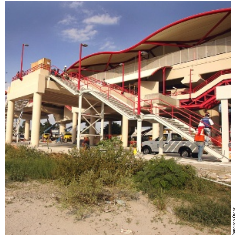
► La zona de transferencia que está planeada en la Estación Sendero es una de las obras del proyecto que no ha iniciado.
